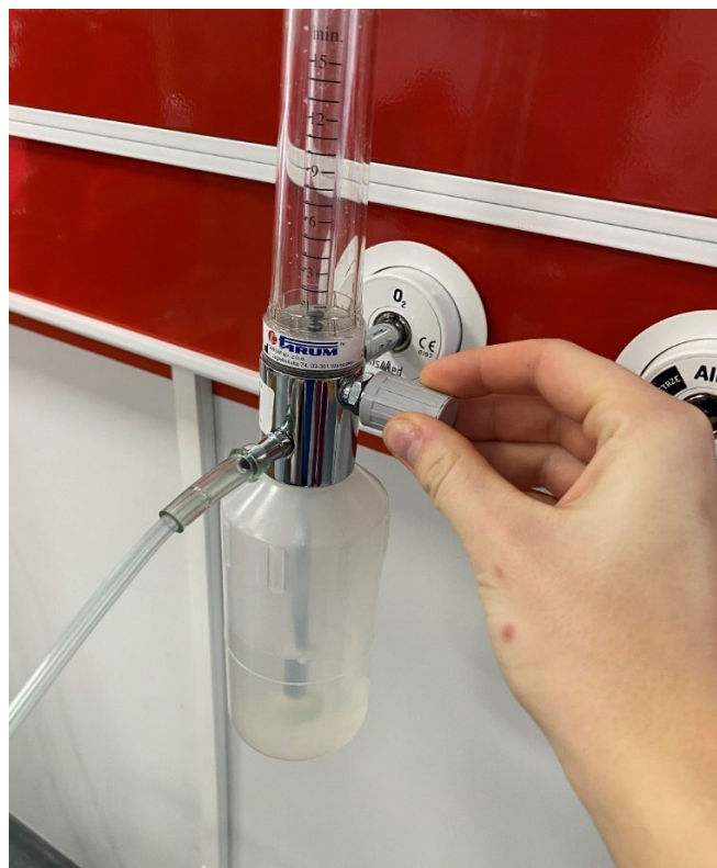
Ryc. 73 Podłączenie reduktora tlenowego do panelu medycznego Źródło: opracowanie własne
