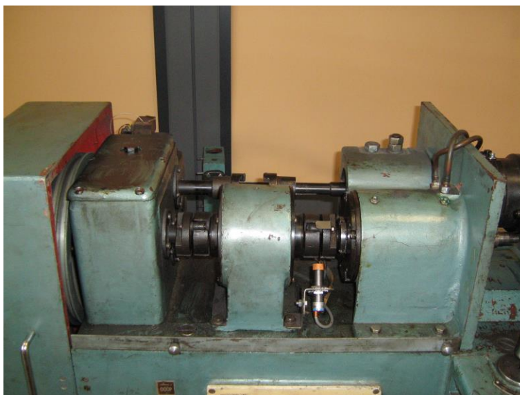
Rys. 4.22.3. Widok wału napędu karetki po zdjęciu osłony. Widoczne przewody wody chłodzącej zasilanej z instalacji wodociągowej. Fot. J. Mikołajczyk
