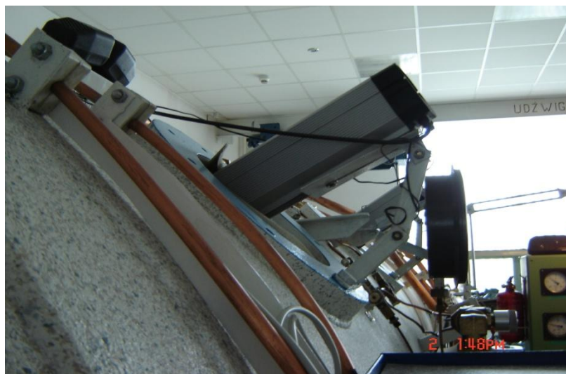
Ryc. 13. System video umożliwia monitorowanie wnętrza komory (Materiał własny).
